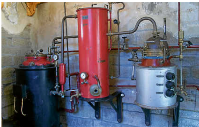
Die Bedeutung des Alkohols für die Pharmazie wird in dem einzigartigen Laborgebäude in Bönningheim dargestellt. Das Foto zeigt eine Bitter-Destillationsanlage. Foto: Kurt Sartorius
